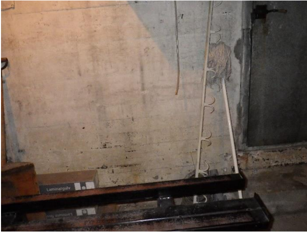
Kuva 17. Kattilahuoneen bitumisively ei sisällä haitallisia määriä PAH-yhdisteitä
